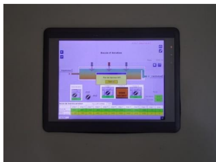
Outil de détection - Supervision
